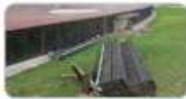
축제장 시설 파손
